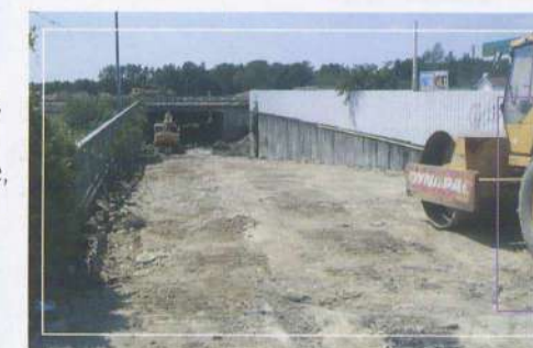
Destruction du pont sur la RN149 avec écran pour protéger les projections d'éclats
